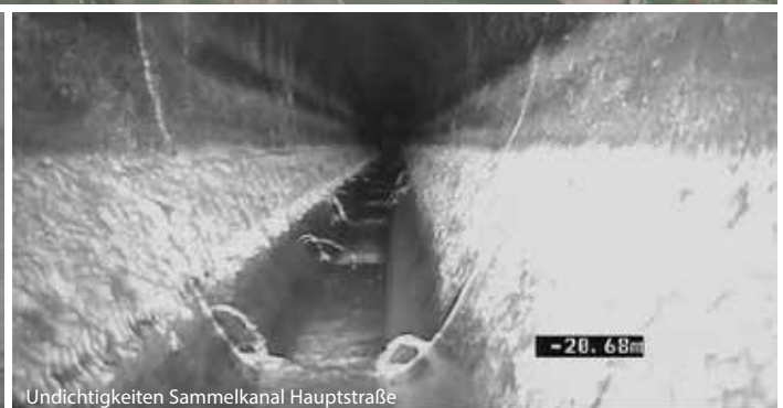
Undichtigkeiten Sammelkanal Hauptstraße
